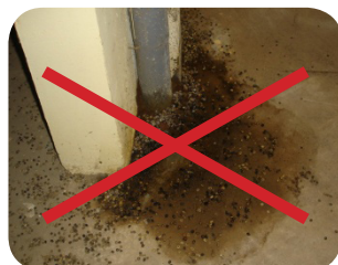
Nền kho bị đọng nước
